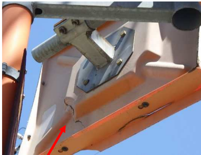
裏面が割れている
