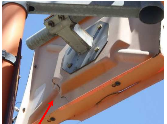
裏面が割れている
