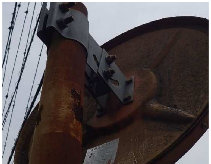
裏面が全体的に腐食している
