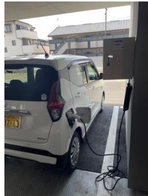
ピロティ駐車場に設置した EV 用充電器
