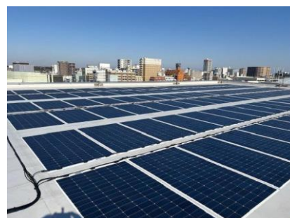
本庁舎に設置したフレキシブルパネル (薄くて軽く、建物への負担が少ない)
