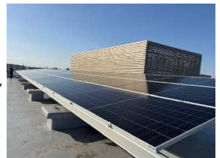
武里南小学校に設置した太陽光パネル
