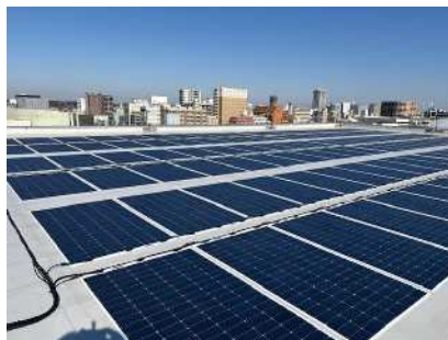
本庁舎に設置したフレキシブルパネル
