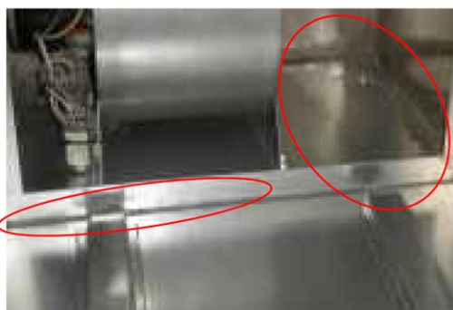
図 4-8 フレームと本体の接合部の隙間のコーキング場所の事例
