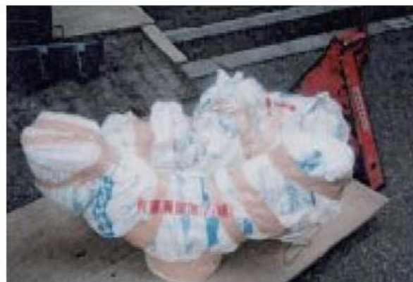
図 4-17 除去した石綿含有保温材配管を梱包し、廃石綿等として処理した例
