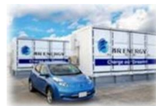
大型蓄電施設
