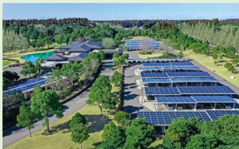
物件名：リエネ季美の森ゴルフ倶楽部太陽光発電所 定格容量：630kW
