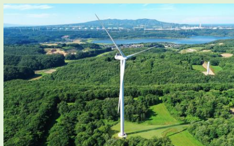
物件名：リエネ六ヶ所村千歳風力発電所 定格容量：36MW
