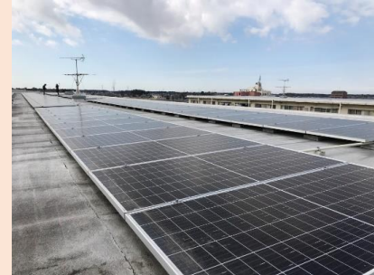
物件名：旧雇用促進住宅屋根置き事業 定格容量：20MW（全2府29県358案件935棟）
