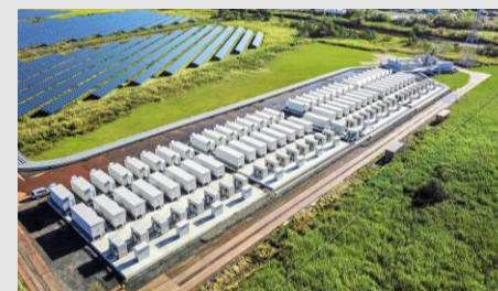
すずらん釧路太陽光発電所の蓄電池
