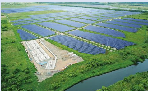
物件名：すずらん釧路町太陽光発電所 定格容量：92MW
