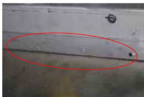
HEPA フィルタ取り付け面
