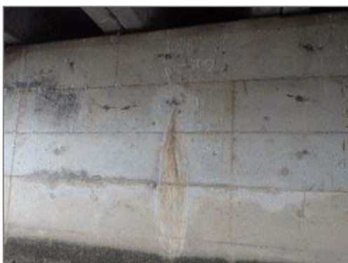
写真 3-7 橋台のひびわれ, 遊離石灰 (C1) : 286. G60 号橋
