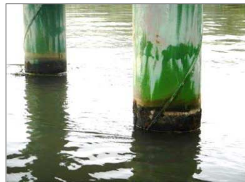
写真 3-6 橋脚の腐食 (C2) : 24. 藤塚橋歩道橋 (下)
