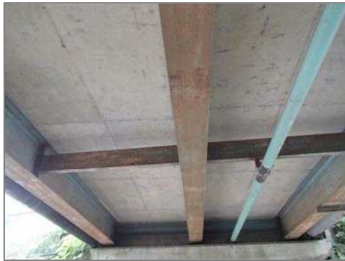
写真 3-1 主桁の腐食 (C1) : 242. F218 号橋 1
