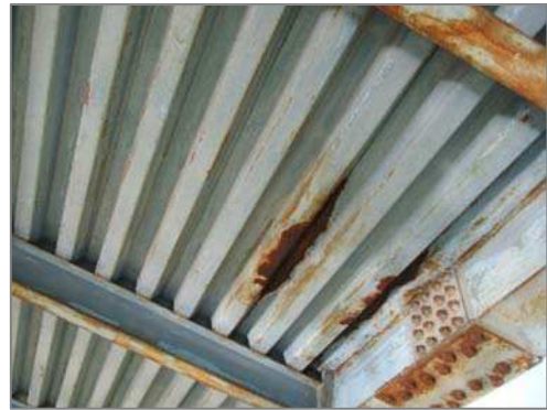
写真 3-2 デッキプレートの腐食 (C1) : 504. 中川人道橋
