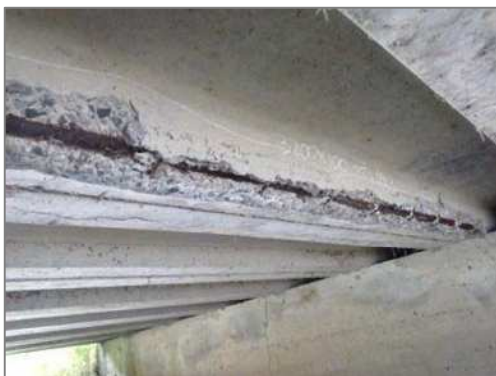
写真 3-5 主桁の剥離・鉄筋露出 (C2) : 405. 2242-1 号橋
