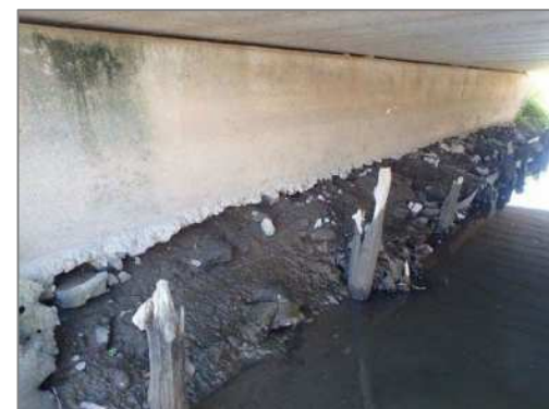
写真 3-8 橋台の洗堀 (C2) : 376. 2001-1 号橋
