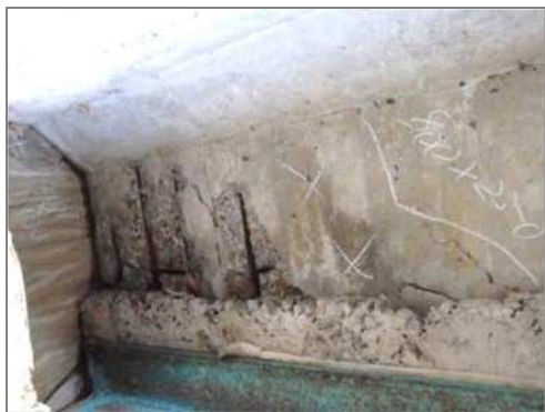
写真 3-3 床版の剥離・鉄筋露出 (C1) : 411. 2250-1 号橋
