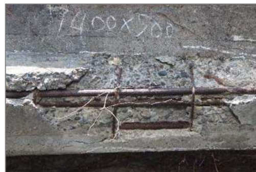
写真 3-4 主桁の剥離・鉄筋露出 (C2) : 308. 天神橋
