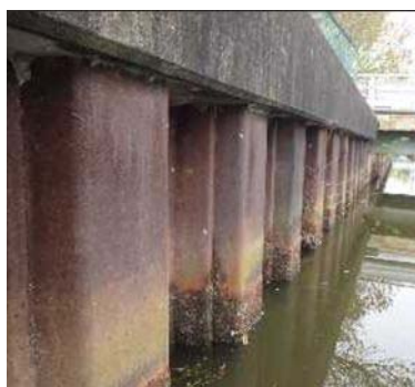
鋼矢板の腐食状況
