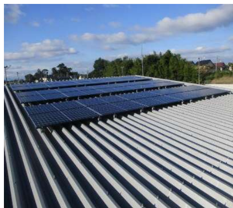
太陽光パネル
