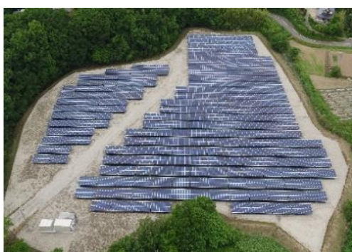
メガソーラー発電所
