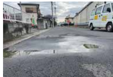
漏水が発生している様子
