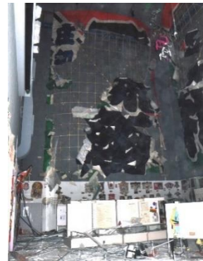
8-3 大凧会館展示室の被災状況
