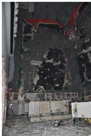
大風会館1階展示室の被災状況（3月11日）
