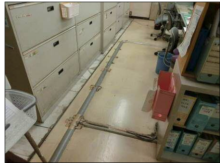
《執務空間④》 電源コードやＬＡＮコードを床上に配線している。
